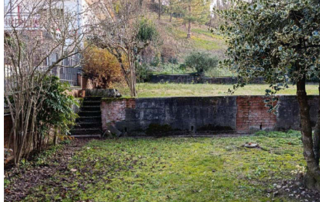
Vista del muretto di contenimento ammalorato
